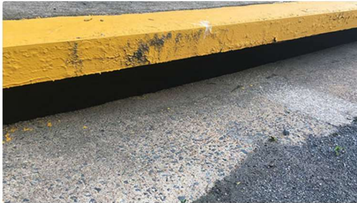
Figura 8: Uma calçada com o meio-fio pintado de amarelo.
